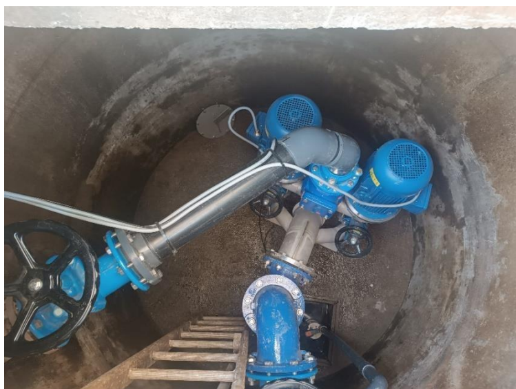
Poste DIP (Eiffage)
