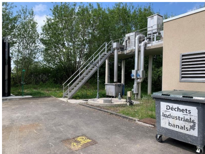
Prétraitement des effluents bruts
