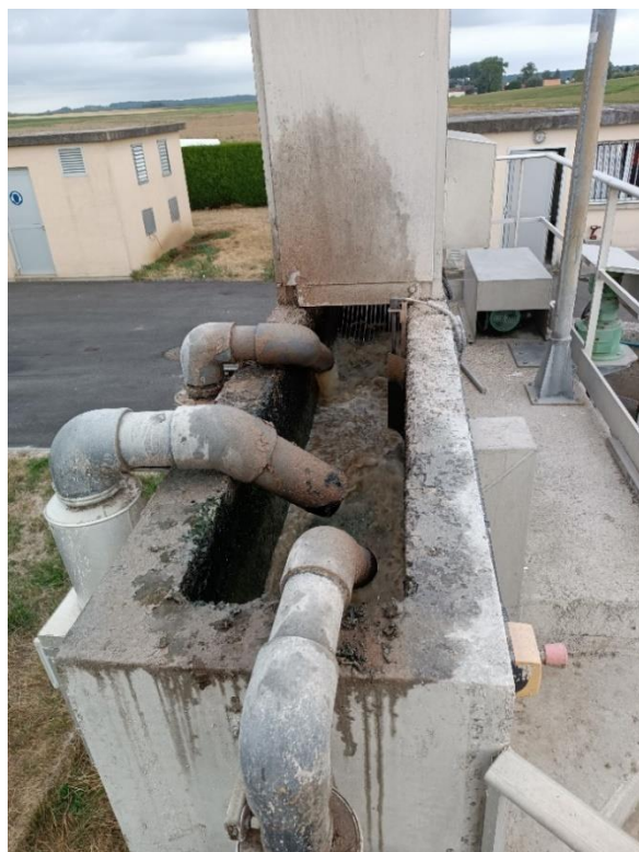
Arrivée des effluents bruts (3 refoulements)
