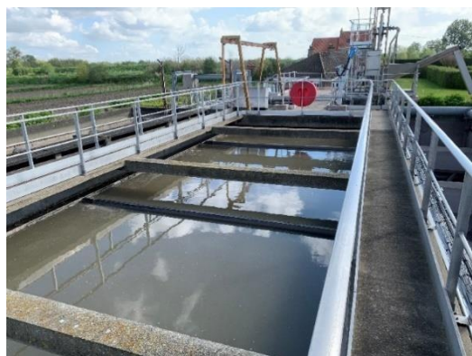
Bassin de prétraitement
